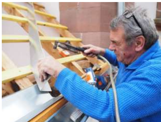
René lors de la construction des toilettes de l'Église Catholique en Octobre 2020
